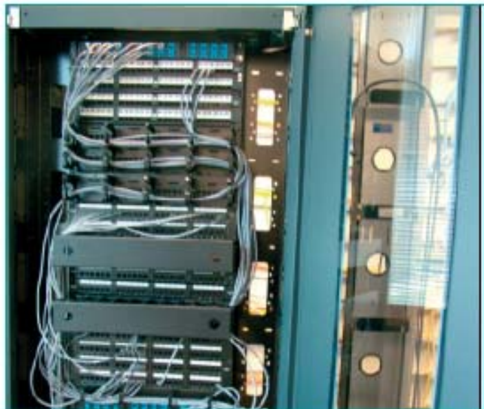
图 4.9 在机柜中使用电缆或跳线管理组件
